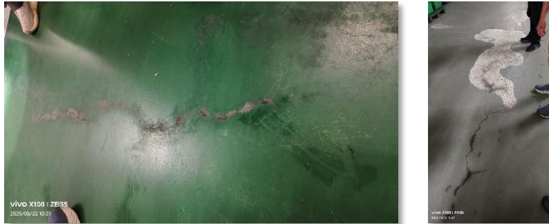
地下室樓地板部分區域龜裂現況
