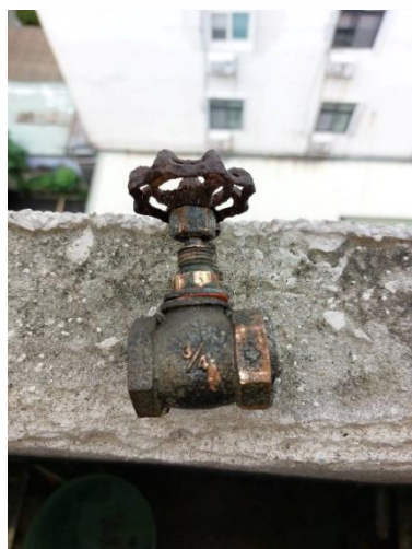
老舊水管旋轉開關閥
