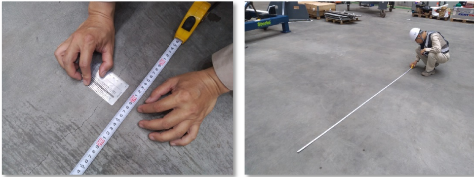
現場測量地坪裂縫長度及寬度
