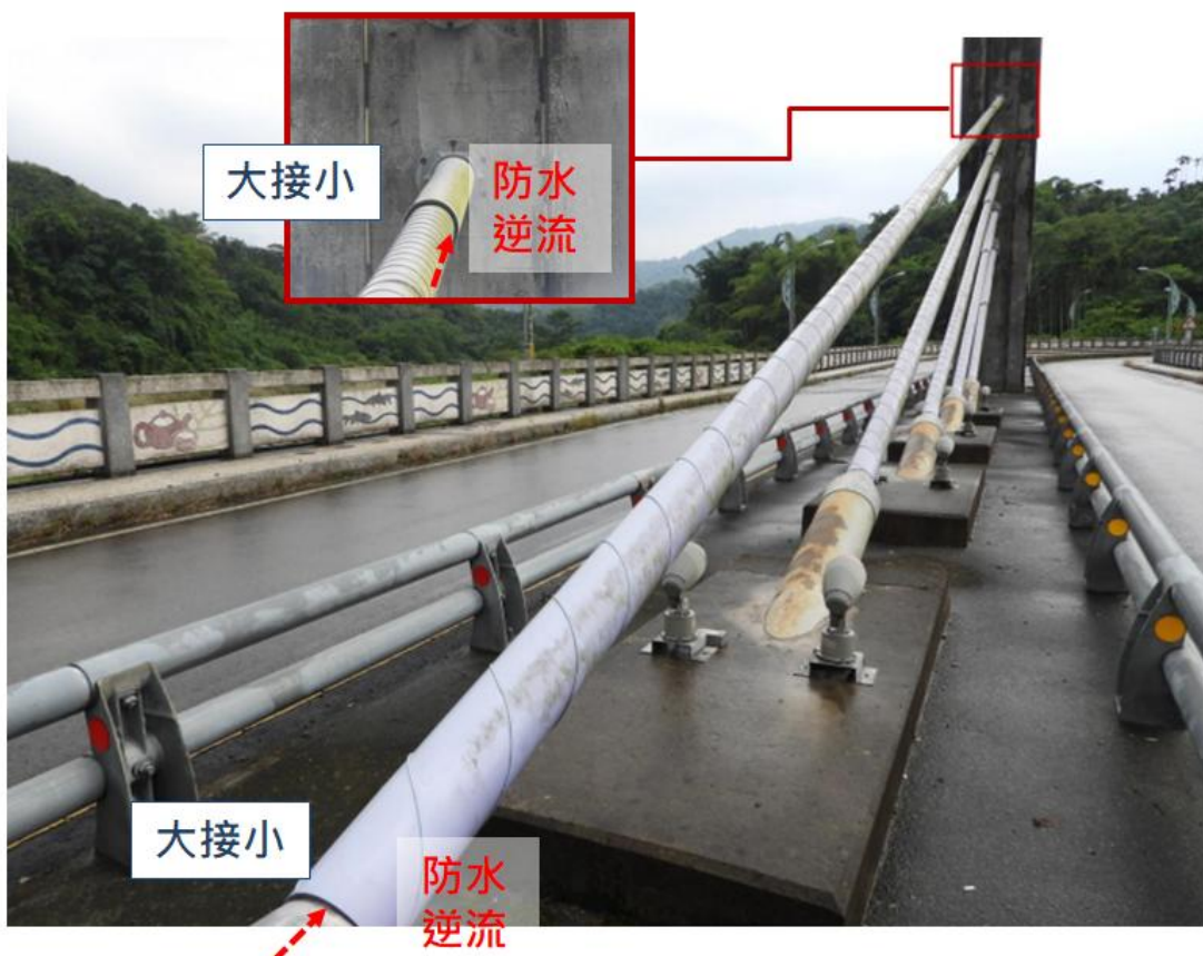
錨碇系統上大接下小現場照片(參考交通部特殊性橋梁研習資料)
